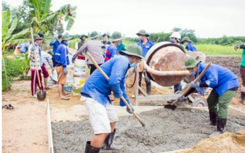
Các "Chiến sĩ" Mùa hè Xanh Duy Tân đang xây đường bê tông
