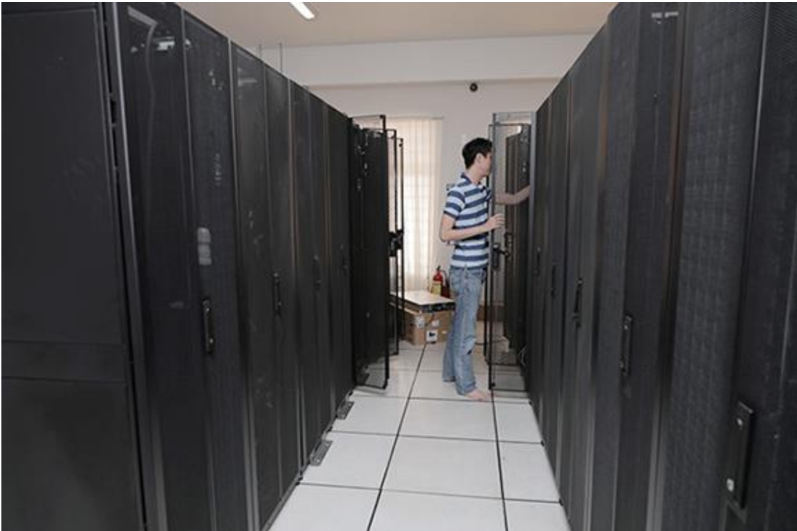
Hệ thống Data Center hỗ trợ công tác đào tạo
